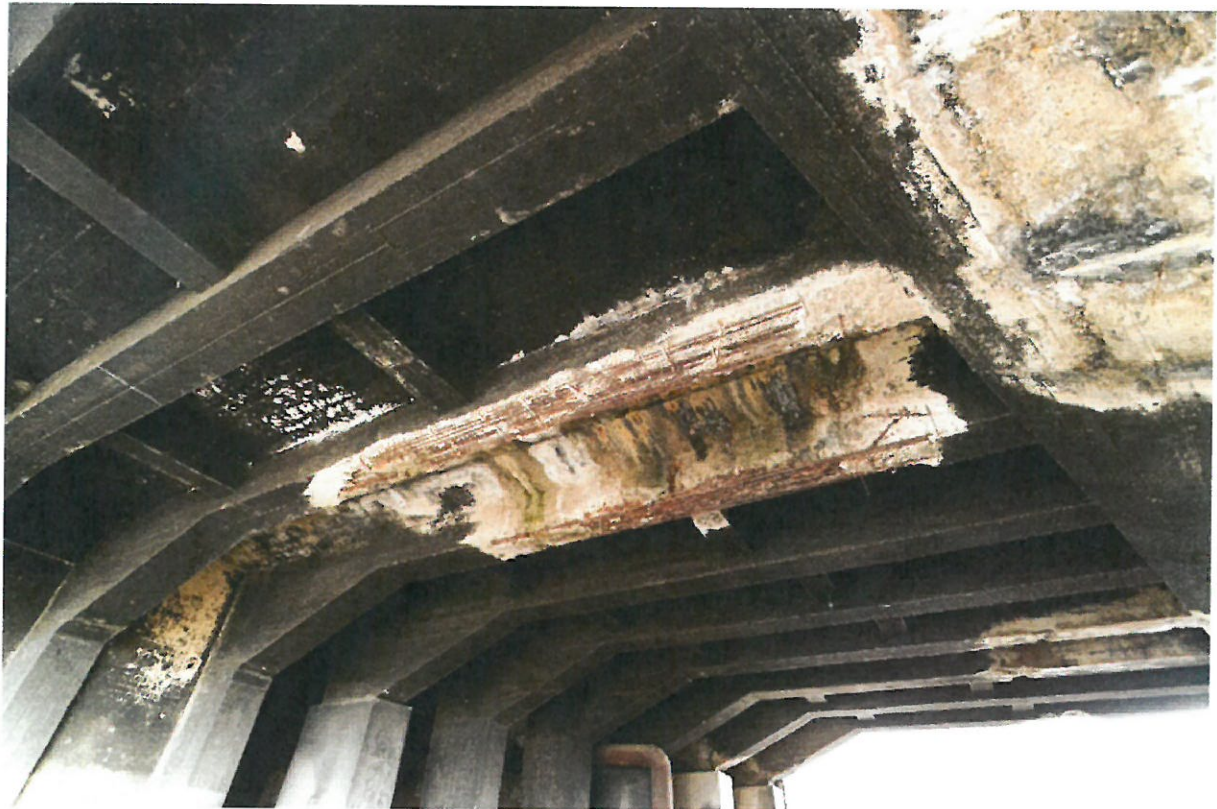
Podhled průjezdu s obnaženou výztuží nosníků rámové železobetonové konstrukce
