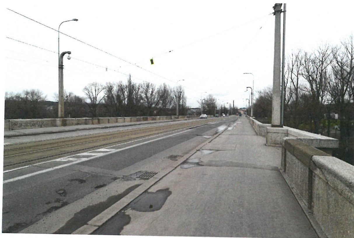
Komunikace na mostě, balkony s kandelábry a nevhodně přidaným novodobým osvětlením
