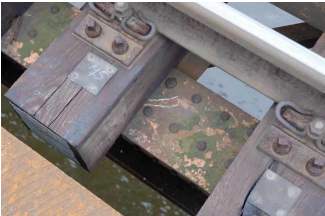
Obr. 11 Únavová trhlina v podélníku (B. Espion, 11. prosince 2024 (také v různých dokumentech)).
