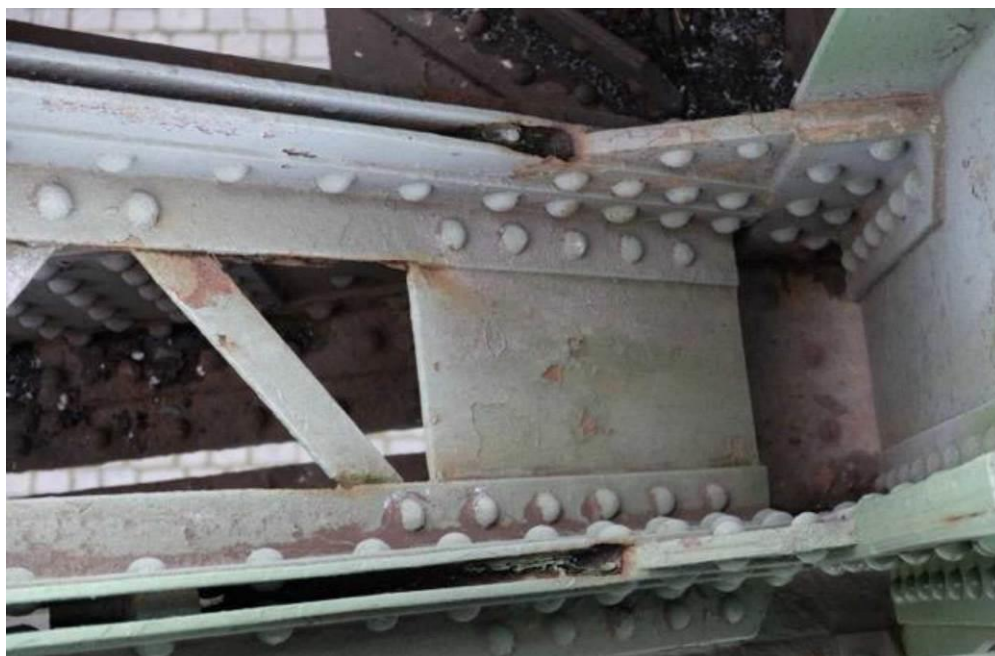
Obr. 9 Typické spojení mezi diagonálou, spodním pásem a svislicí, s úhelníky a styčnickovými plechy spojenými nýty. (B. Espion, 11. prosince 2024).
