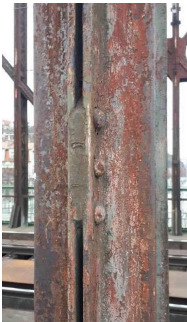
Obr. 4 Rozpadající se vrstvy nátěru na ocelové konstrukci mostu (Paul Drury, 11. prosince 2024).
